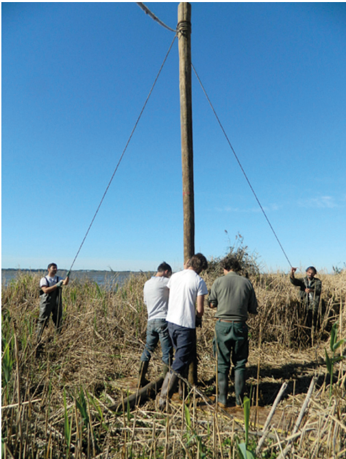
Figura 4: Fissaggio dell'isola palustre di 10.000 mq mediante l'infissione manuale di pali in legno.
